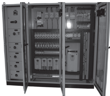
Figura 4.13 | Centro de controle de motores
